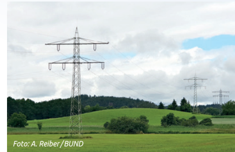
Foto: A. Reiber / BUND 110-kV-Trasse Stockach-Wollmatingen
